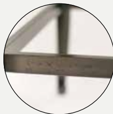
Spots on steel Taches sur l'acier
